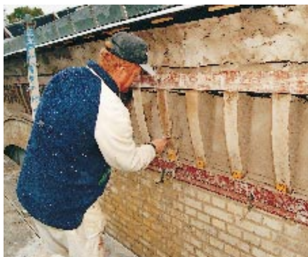
Med hydrauliskt kalkbruk från Stråbruken renoveras Renströmska badet i Göteborg. Över 2 000 ton bruk levereras.
