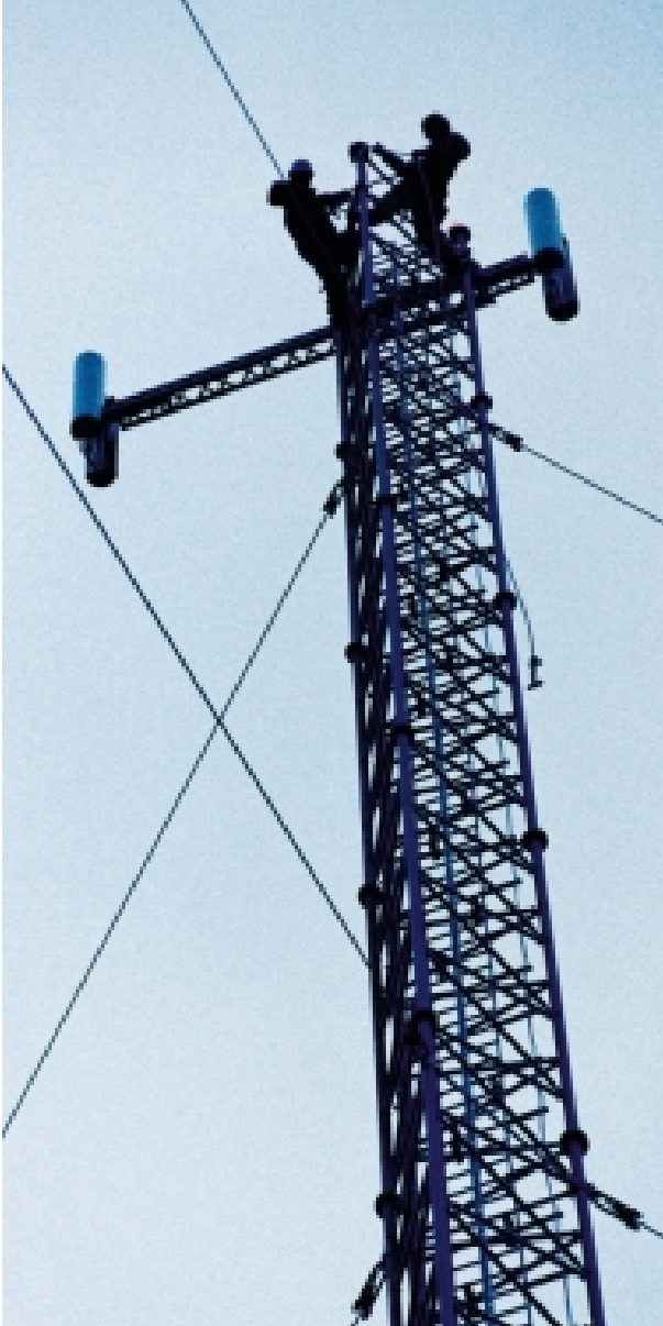
En basstation för tredje generationens mobilsystem (3G) varierar i storlek och komplexitet. I det här fallet, i Bergshamra utanför Norrtälje, behövde kunden en hög mast.
